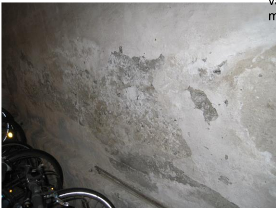
Let fugtskadede kælderydervæg
