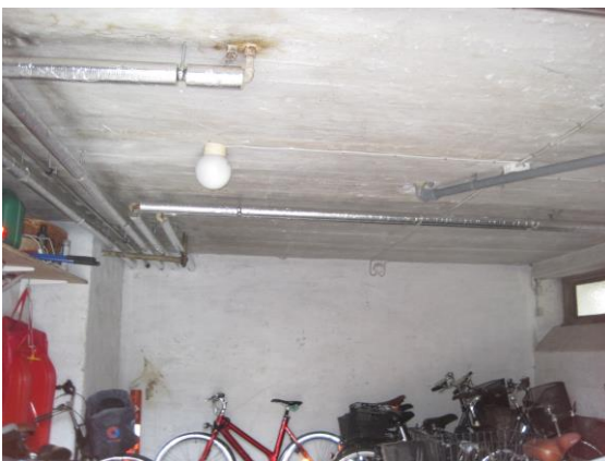
Uisoleret etagedæk i cykelkælder
