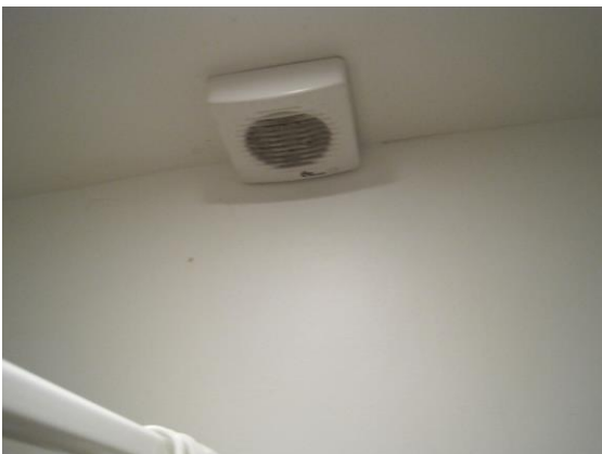
Udsugningsventilator i bad
