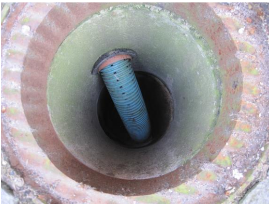
Nedløbsbrønd med lydæmper.
