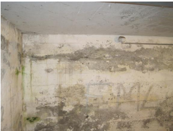
Revnet og vandskadedet beton i garagen
