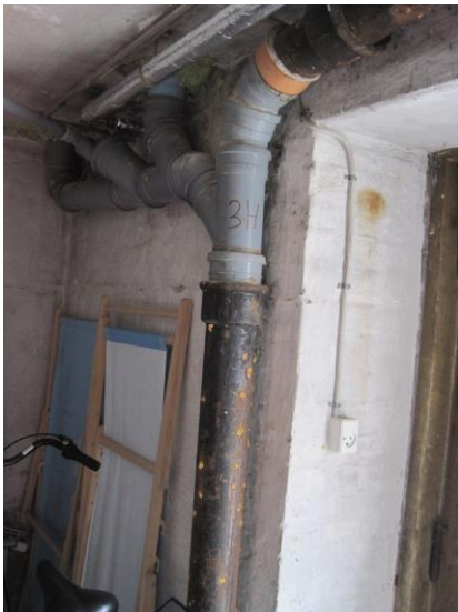
Faldstamme i cykelkælderen
