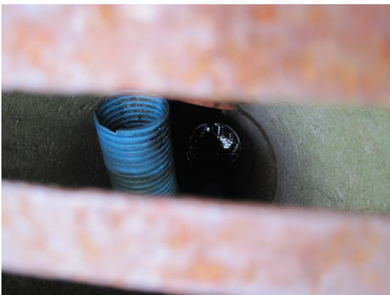
Nedløbsbrønd hvor lydæmper er faldet af.
