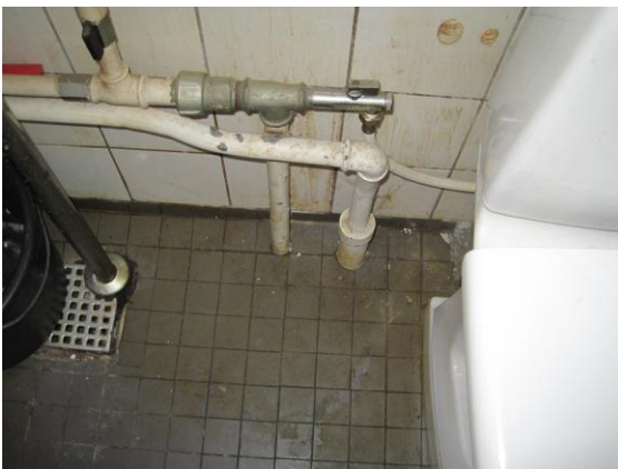
Vandrør i bad.
