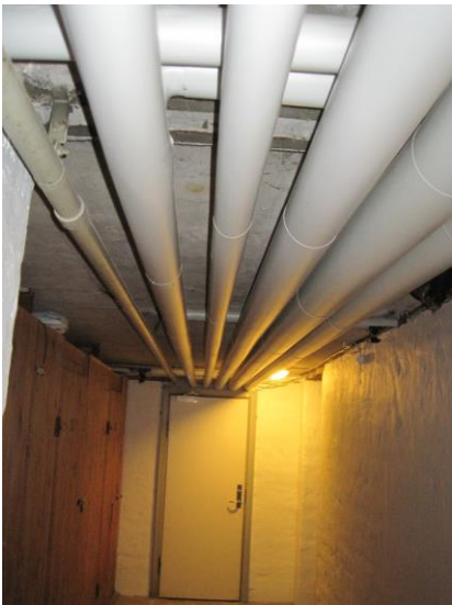
Hovedrør i kælderen
